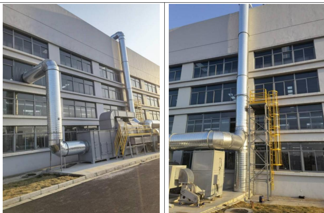
废气处理设施
